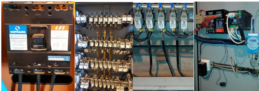
Figura 5 – Banco de Capacitores
